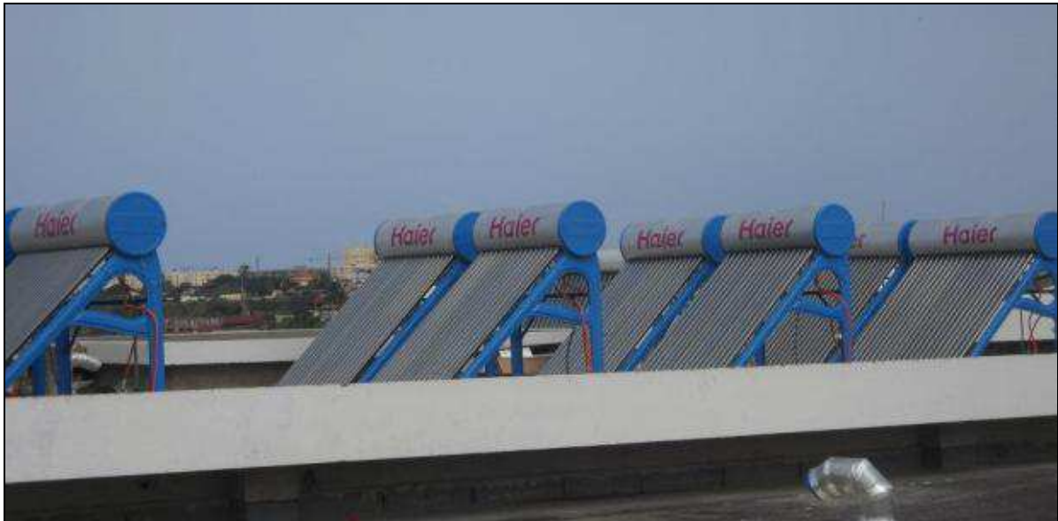
Figure 8: Photo de chauffe-eau solaires dans un Hôtel 4 étoiles au Sénégal
