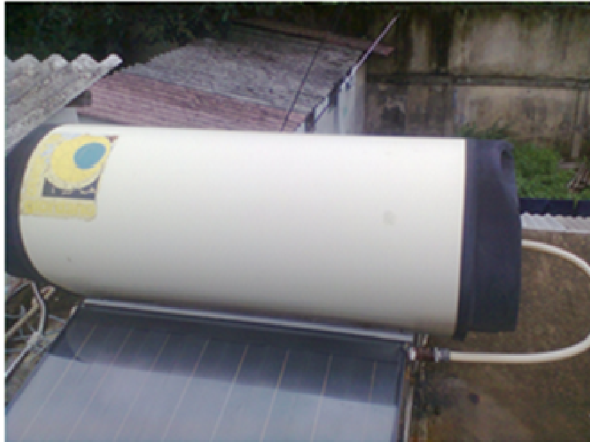
Figure 10: Photo de chauffe eau solaire à plan vitré dans une maison
