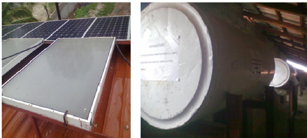
Figure 13: Photos de chauffe-eau solaire à circulation forcée dans un hotel
